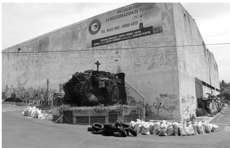
3. Vista panorámica donde se observa el deterioro del monumento a la piedra.
